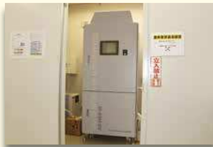
液体窒素自動供給装置 JSN-100DP-AS (日本サーマルエンジニア リング)
